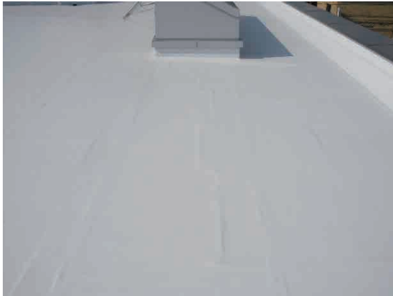
断熱材の段差
